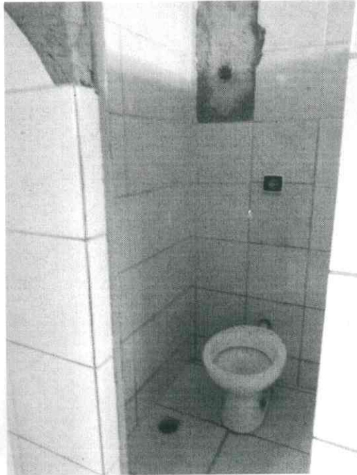
Figura 14: Ausência azulejo e ralo.
