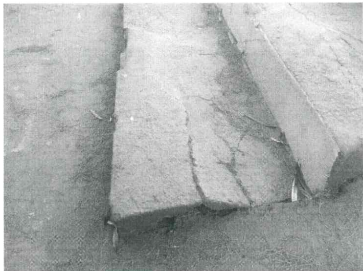
Figura 12: Patologia na arquibancada.
